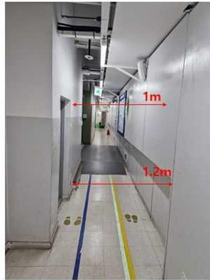
인허가시 편법 설계/시공 의심
